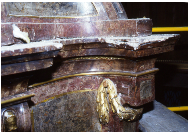
Dégradation du maître-autel
